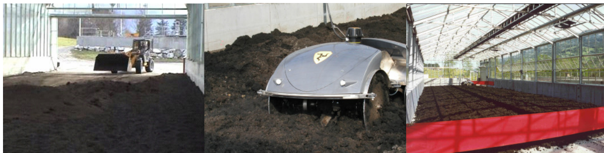
Cuadro 2: Secado solar de lodos previamente deshidratados (alimentación, distribución, secado)
